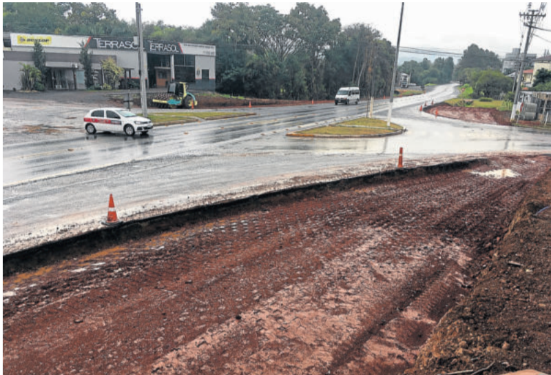
Rótula da Rua Major Bandeira (bairros Languiru e Alesgut) segue em obras
