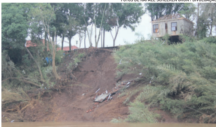
Rua Oswaldo Aranha - casa pendurada sem telhado
