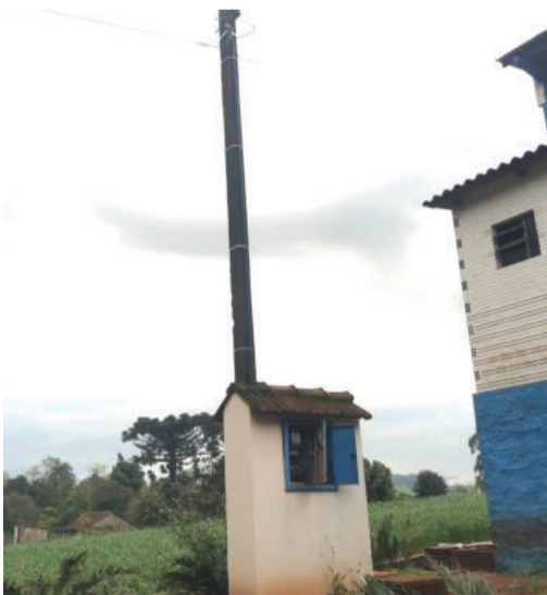
Suspeita é que o raio tenha entrado externamente e depois se espalhado pela rede elétrica
