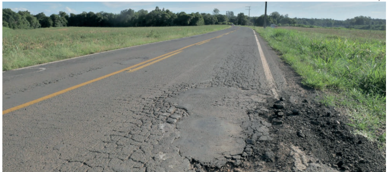
Estrada necessita de melhorias
