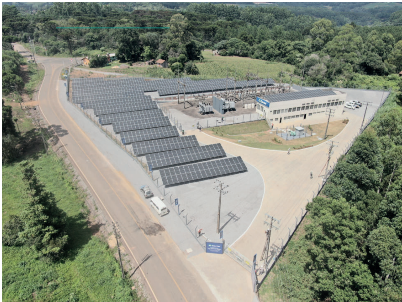
Usina Fotovoltaica da Certel de São Pedro da Serra
