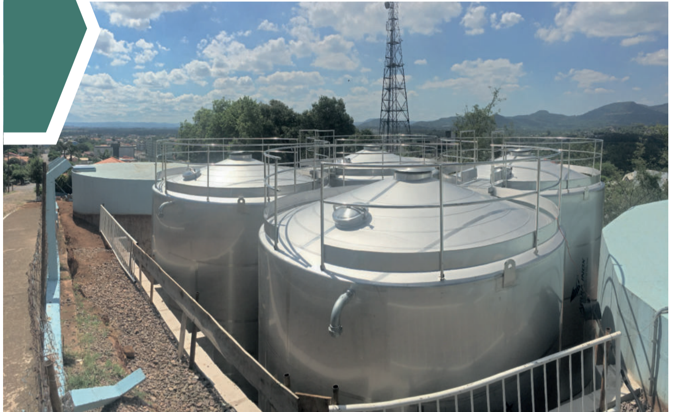
Quatro novos tanques de inox foram instalados pela APDL
