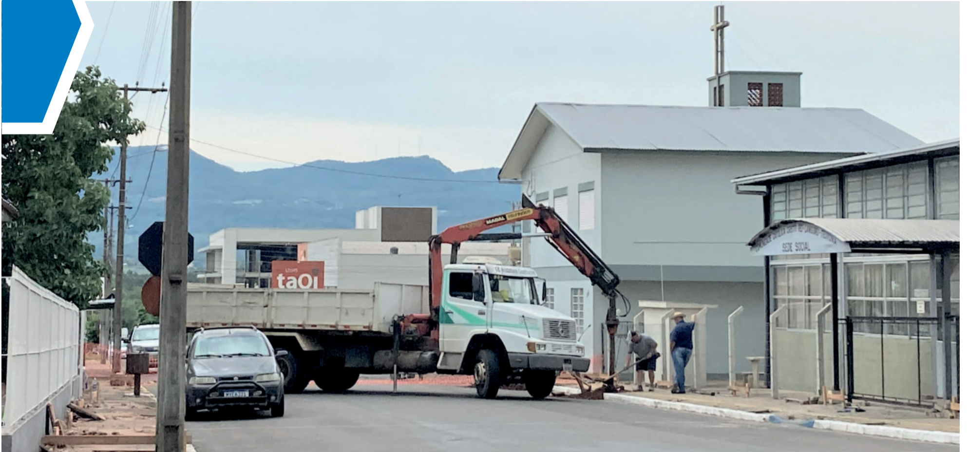
Construtora Edil começou a implantar a estrutura na tarde de quinta-feira (3/2). Cobertura terá 25 metros de extensão e 275 metros quadrados
