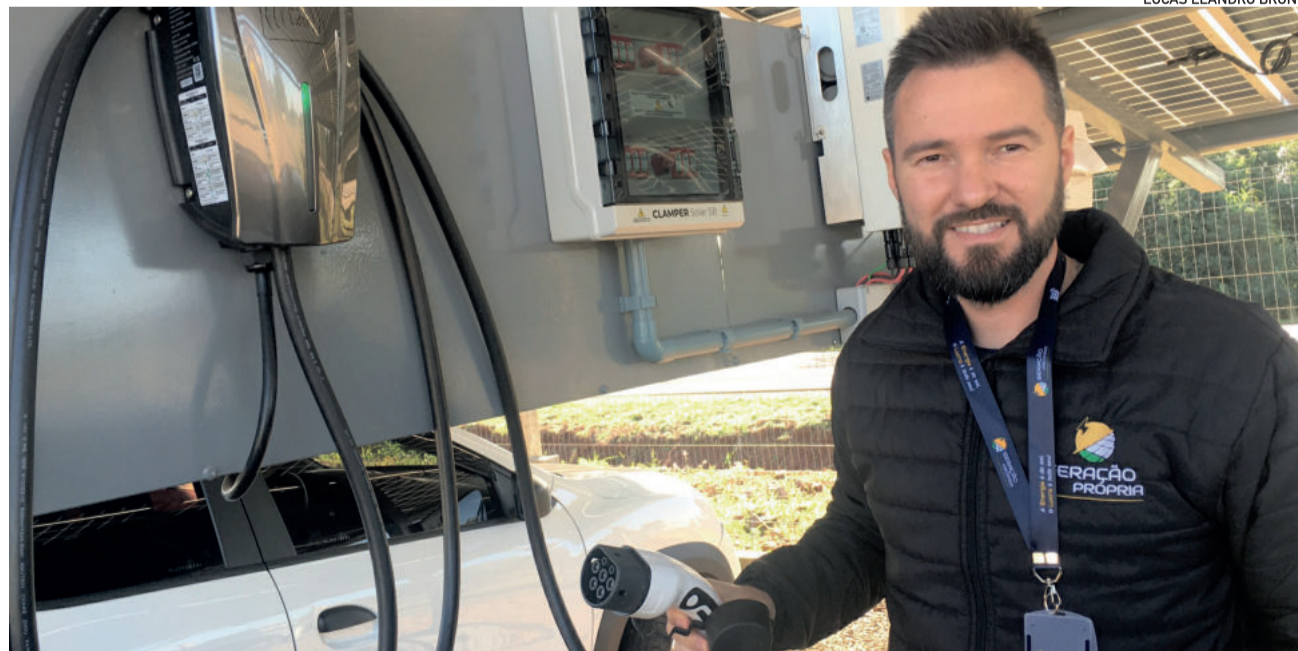
Marcos Pies demonstra uso do Car Port instalado na sede da Geração Própria, em Estrela
