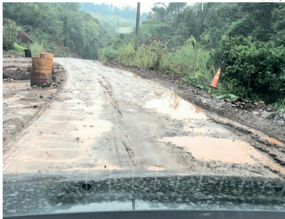
Estrada se encontra em condições degradantes
