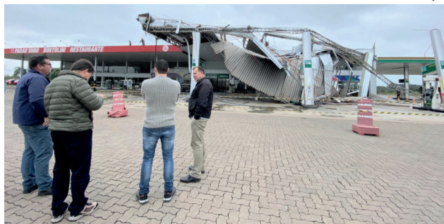
Posto Fórmula teve toda a estrutura do telhado danificada
