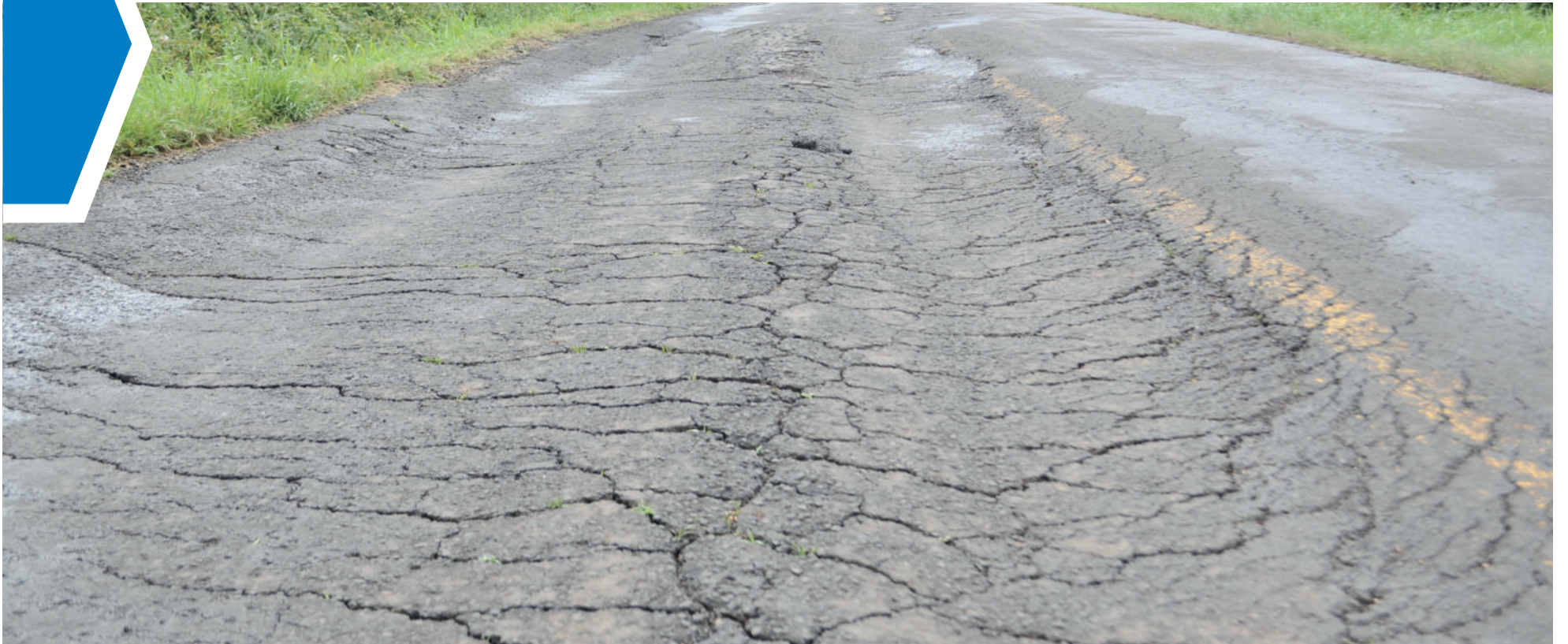
Rachaduras e buracos fazem parte do trajeto em Linha Germano
