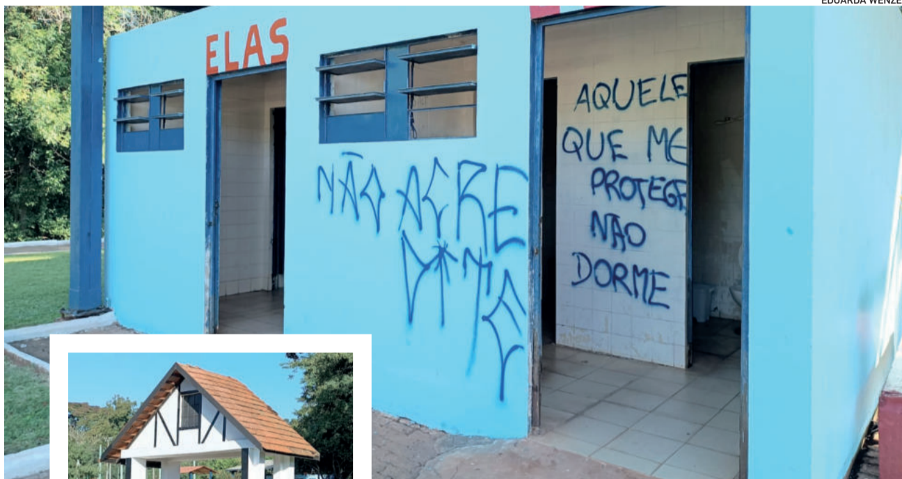
Pichação foi feita um mês após paredes serem pintadas
