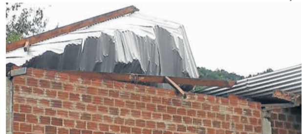
Telhado e paredes foram danificados
