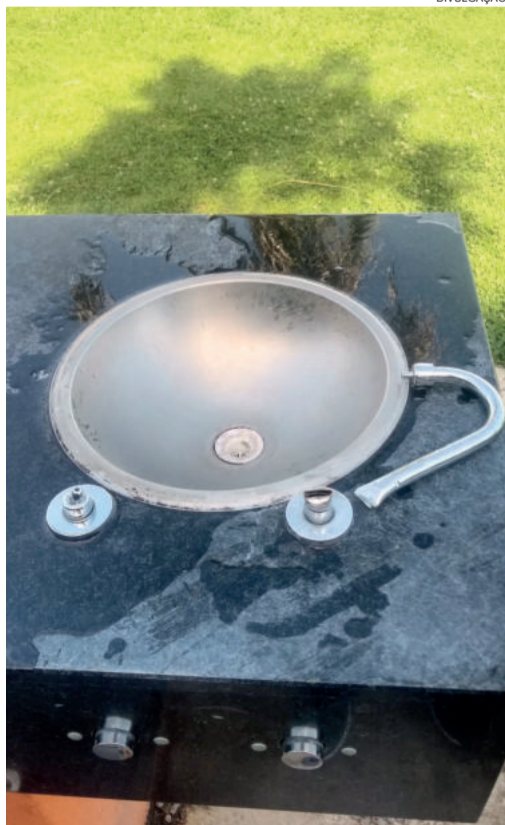
Torneiras dos bebedouros foram danificadas
