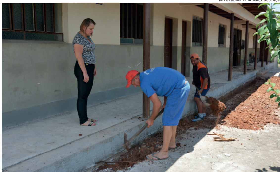
Parte interna e externa necessitava de melhorias urgentemente
