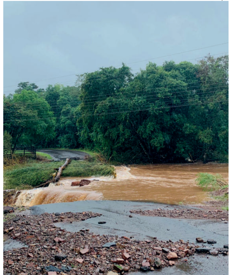
Em Pontes Filho, força da água destruiu asfalto e ponte
