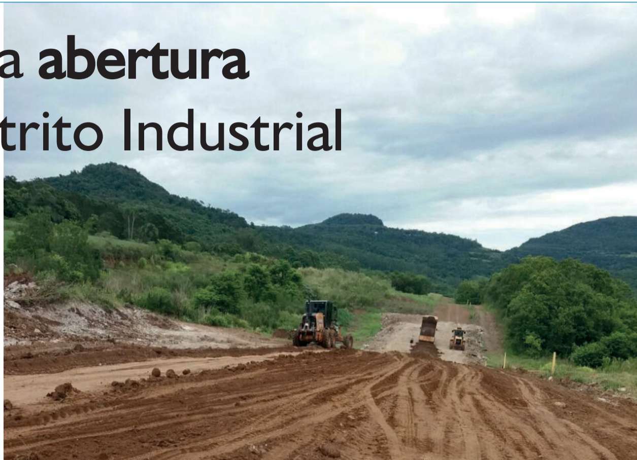
A Prefeitura de Teutônia iniciou, na última semana, o trabalho de infraestrutura no Distrito Industrial
