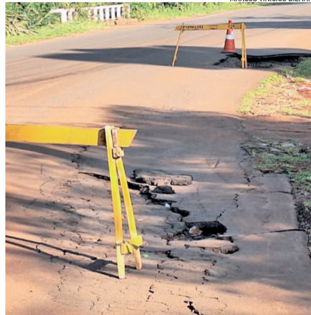
Na estrada de Posses, trânsito está em uma via devido ao asfalto cedido
