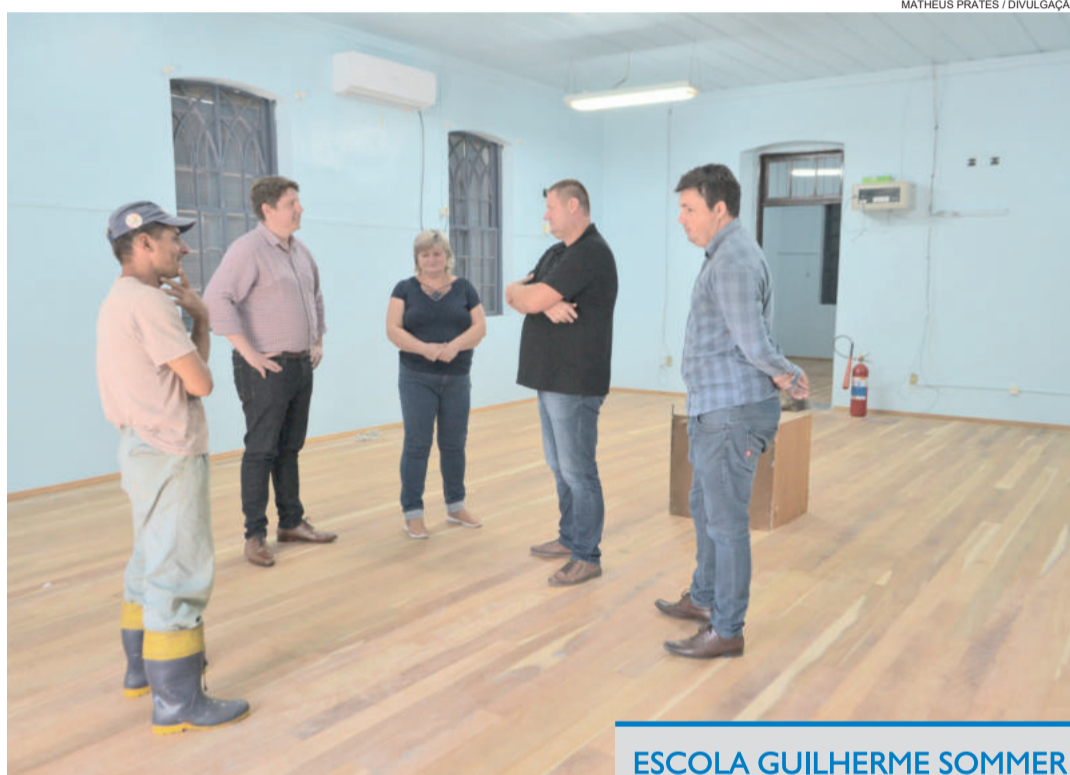
Escola Dom Pedro I está recebendo reforma de piso, janelas e portas
