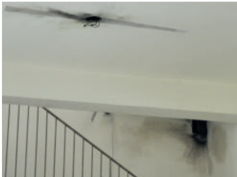
Toda a fiação elétrica do prédio foi danificada
