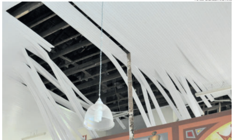
Raio destruiu parte do telhado da igreja
