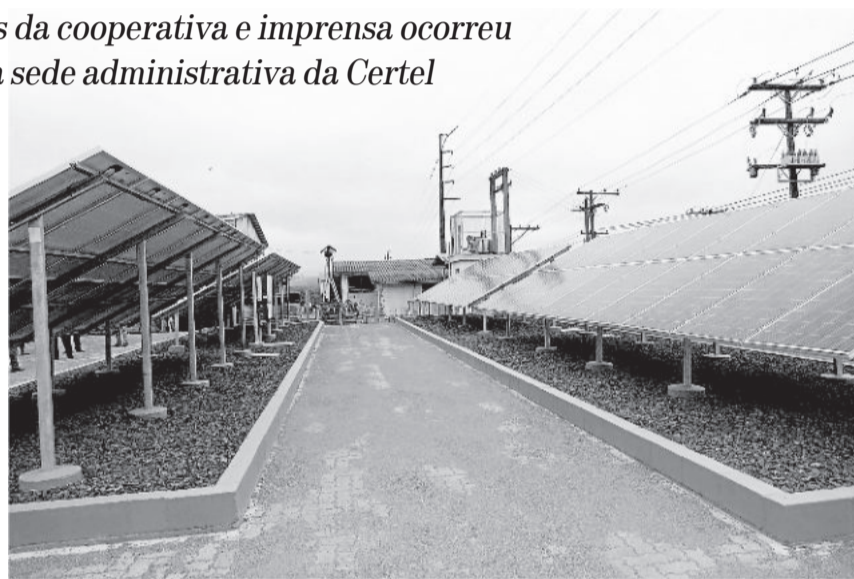
78 placas solares foram instaladas na Certel para testes
