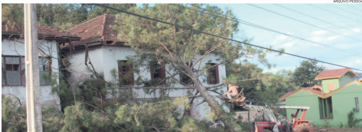
Na ação do dia 1º de abril, uma árvore tombou em cima da construção, destruindo parte do telhado mas não afetando as paredes
