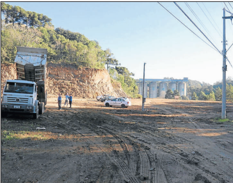
O terreno já está demarcado para a obra, que conta com serviços preliminares
