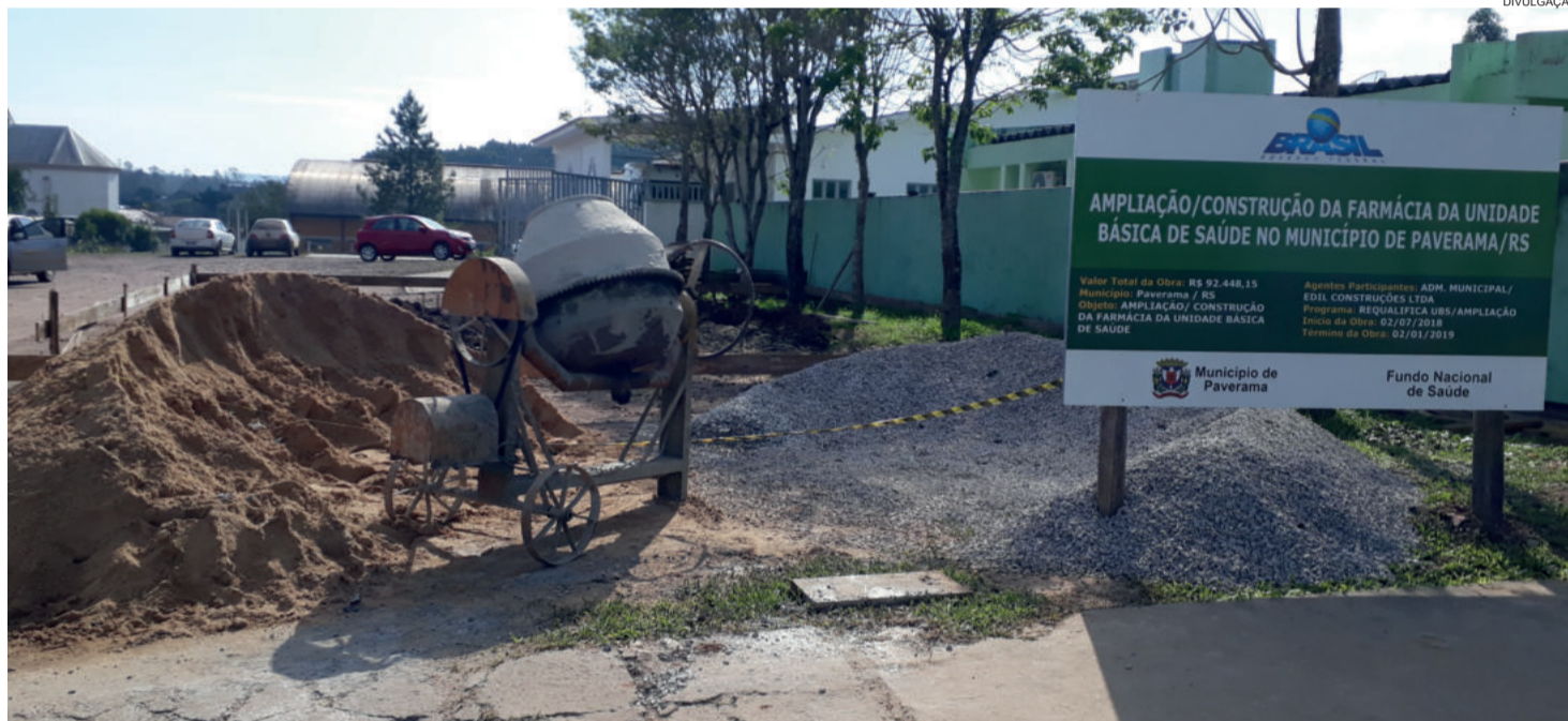
Obras da nova farmácia está sendo construída ao lado do Posto de Saúde
