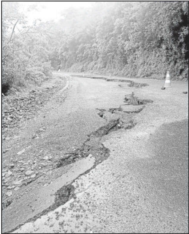
Trecho cedeu com a forte chuva
