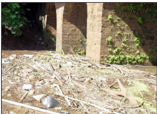
Lixo dificulta o fluxo da água no Arroio Estrela
