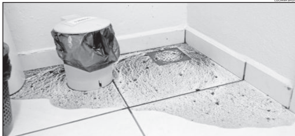
Problemas foram constatados no esgoto
