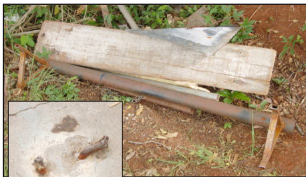
Barras de ferro foram arrancadas
