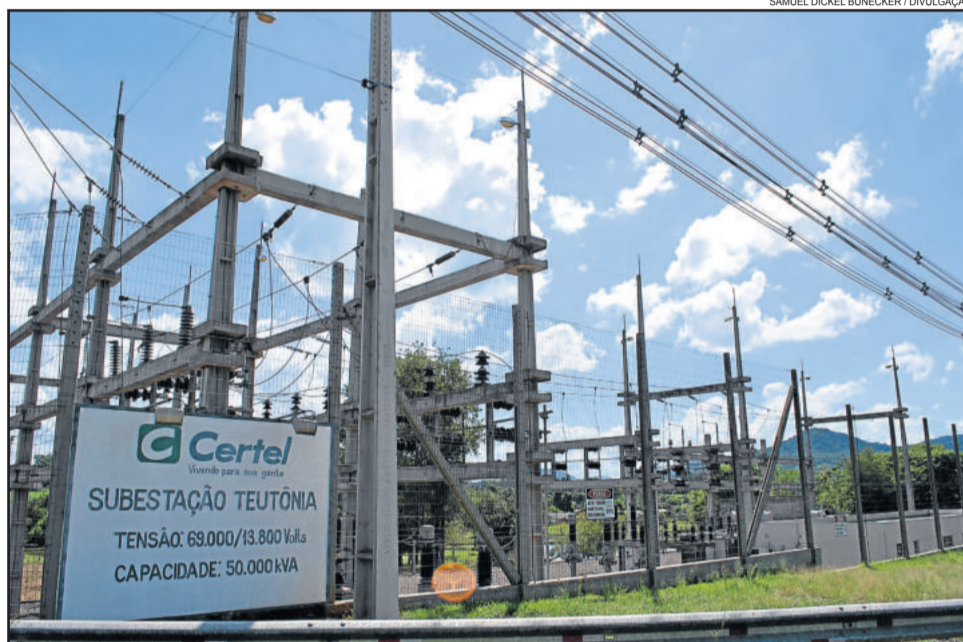
Subestação rebaixadora de Teutônia
