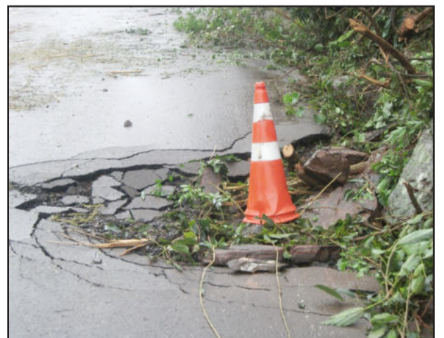
Rachaduras foram registradas no asfalto
