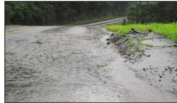
Danos na Harmonia Alta
