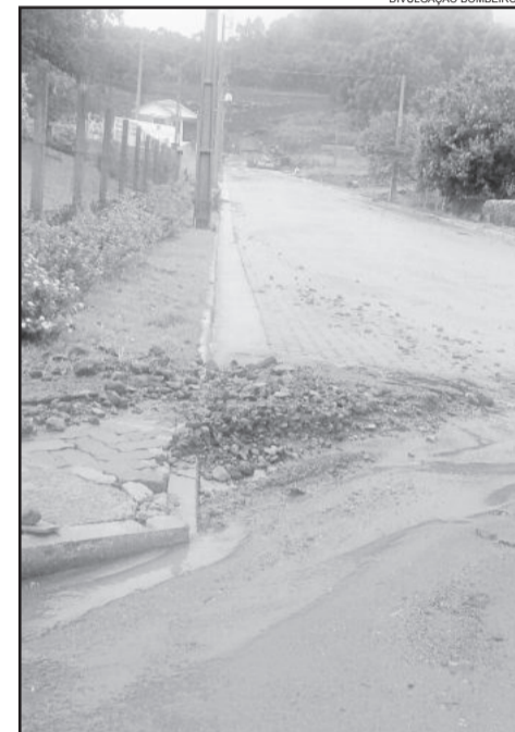
Por causa de bueiro entupido, água arrastou materiais sobre a via
