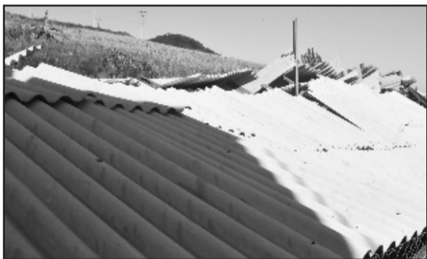
Extensão de 140 metros do aviário foi totalmente ao chão
