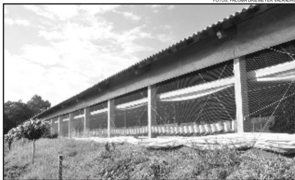
Parte do aviário, erguida de tijolos, não foi afetada
