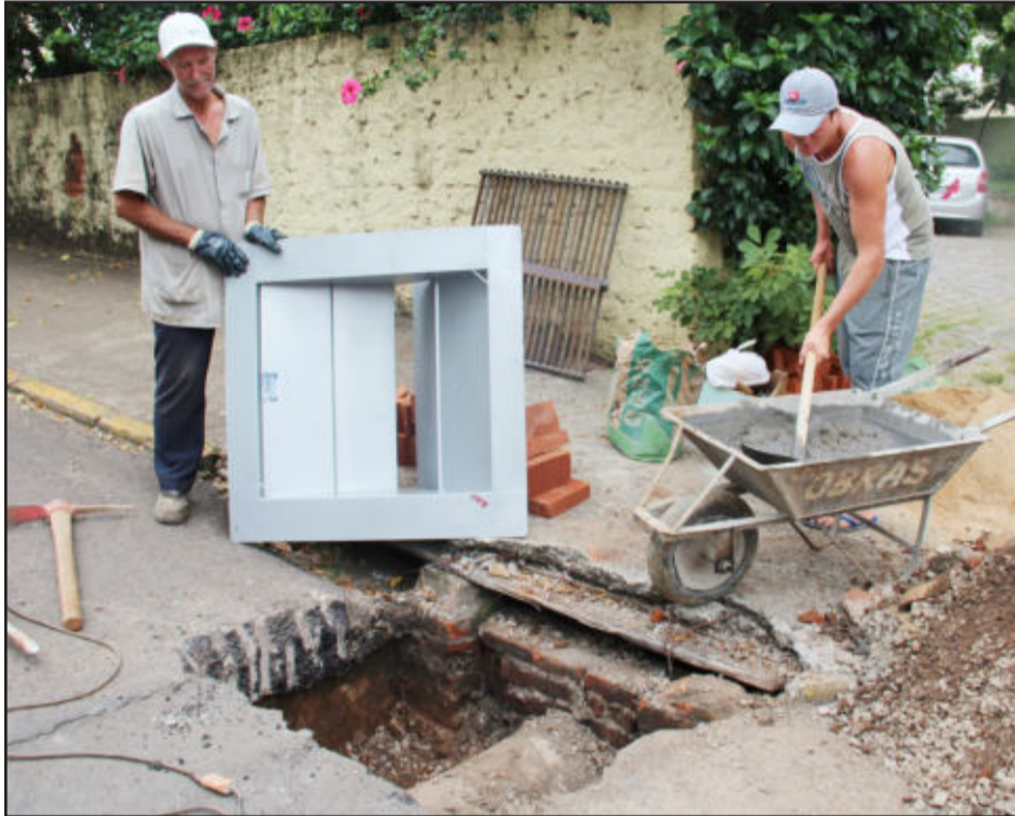
Boca-de-lobo só abre com a presença de água
