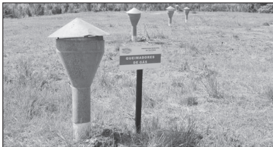
Queimadores são importantes para queimar o gás metano, que é 21 vezes mais poluente que do dióxido de carbono
