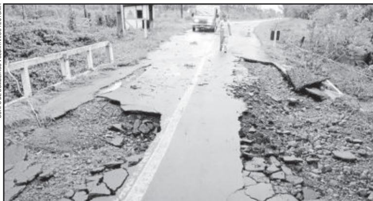
Estrada de Linha Catarina foi danificada pela chuva
