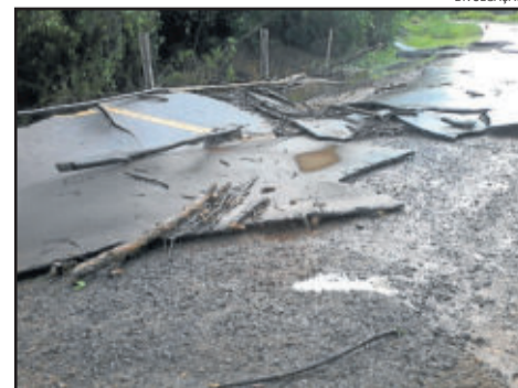
Asfalto arrancado em Pontes Filho
