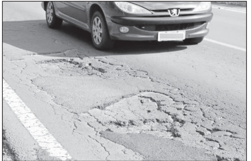
Nas proximidades do acesso a Morgenland está um dos pontos mais críticos
