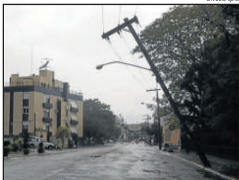
Postes caídos em Estrela
