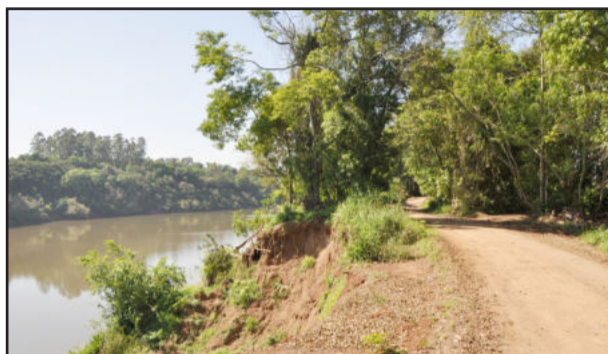
Crateras à beira da estrada ofereciam risco à passagem de veículos
