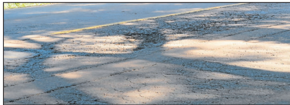
Pista de rolamento está deteriorada
