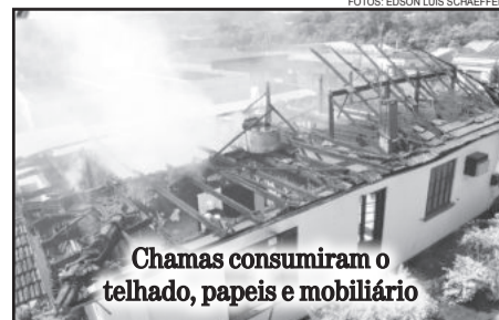
Incêndio teria começado no telhado
