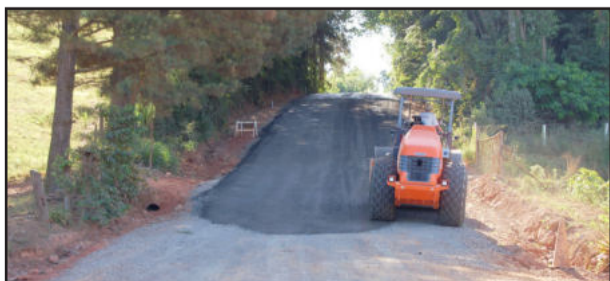
Em outro trecho da estrada, preparação da base é executada pelas máquinas
