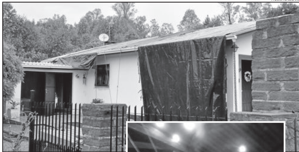
Granizo danificou telhados
