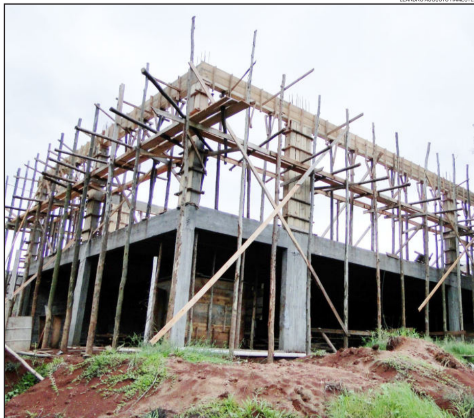
Novo prédio, erguido ao lado e interligado com a estrutura atual, terá 419,4m 2
