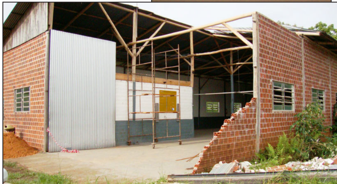
Danos no depósito de ração
