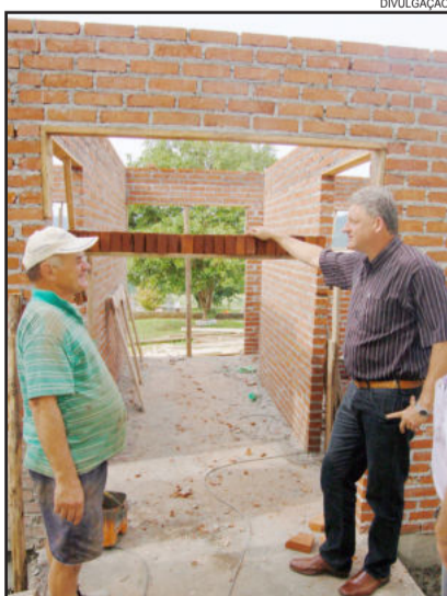
Magedanz (d) conferiu o andamento das obras dos novos banheiros em Linha Clara
