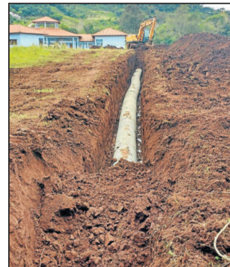
Tubulação na escola Bairro Esperança
