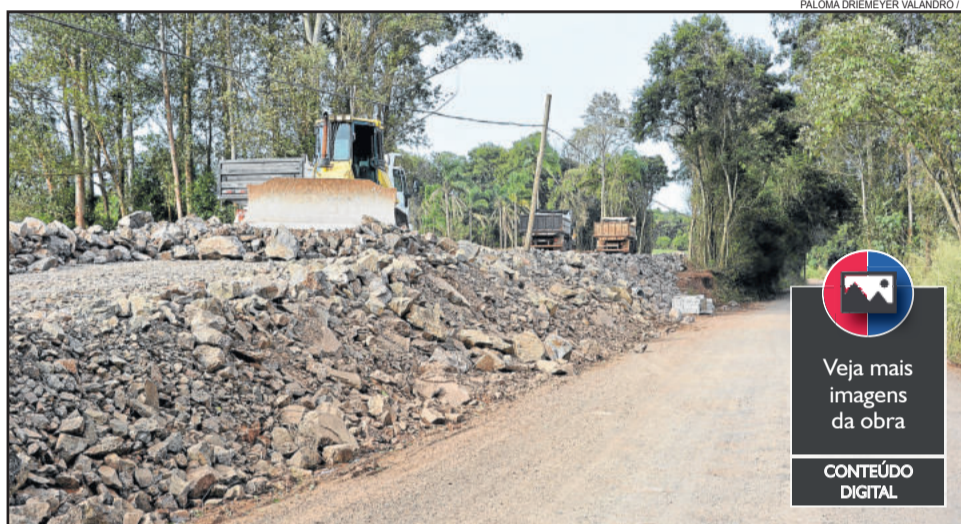
Elevação de estrada atende um antigo anseio dos moradores do Travessão, que ficam ilhados em dias de cheia do Arroio Boa Vista
