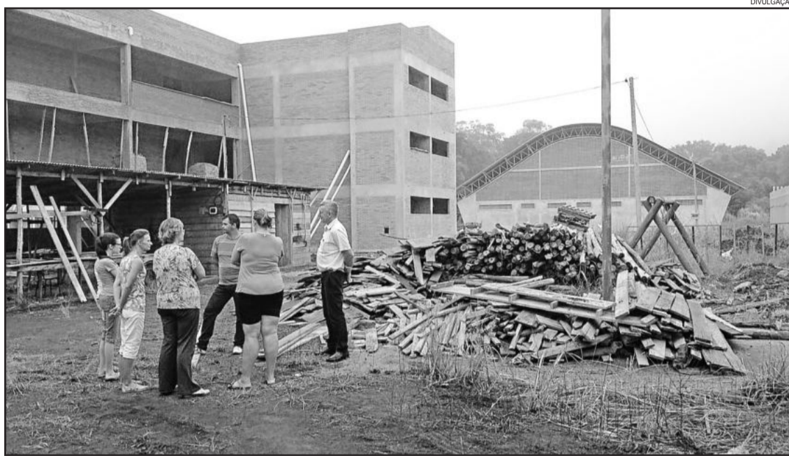
Comitiva acompanhou evolução da ampliação da Escola Vila Schmidt e a construção do ginásio no Complexo Escolar
