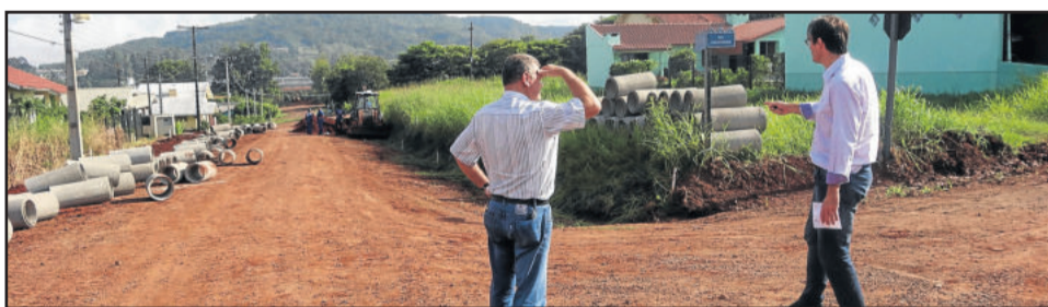
Nas ruas Carlos Krüger e Osvaldo Dienstmann ocorre a canalização e a terraplenagem para asfaltamento
