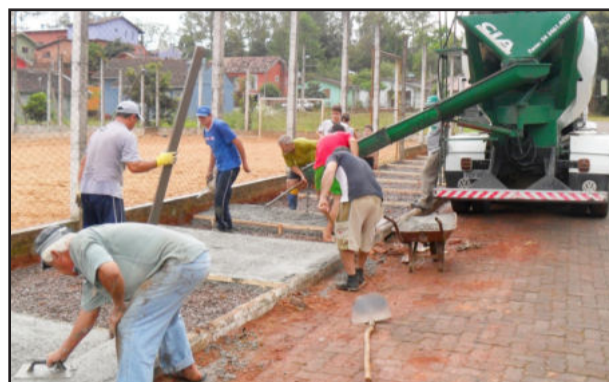
Administração Municipal forneceu o concreto e moradores a mão-de-obra para construir a calçada no Arco Íris
