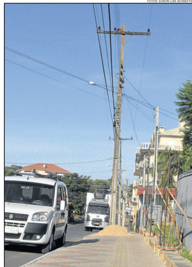
Fiação elétrica, além das tubulações, pode inviabilizar plantio de árvores
