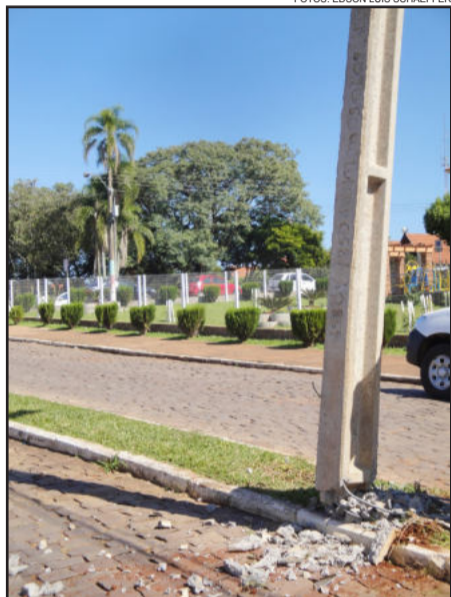
A base do poste chegou a ser deslocada
