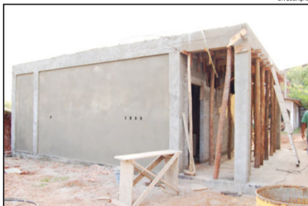
Bloco construído no ano passado já ficou com esperas para receber ampliação
